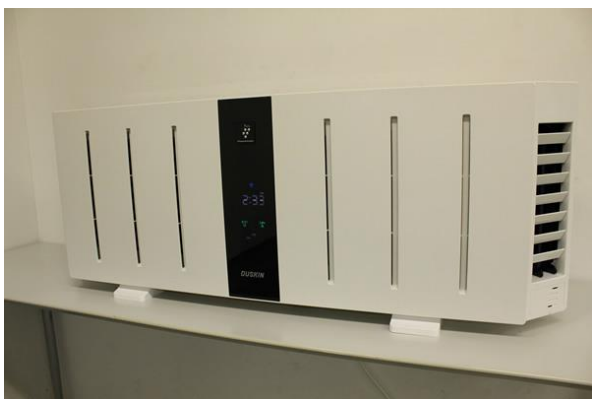
教室内に、空気清浄機を設置しています (写真：各教室内)
