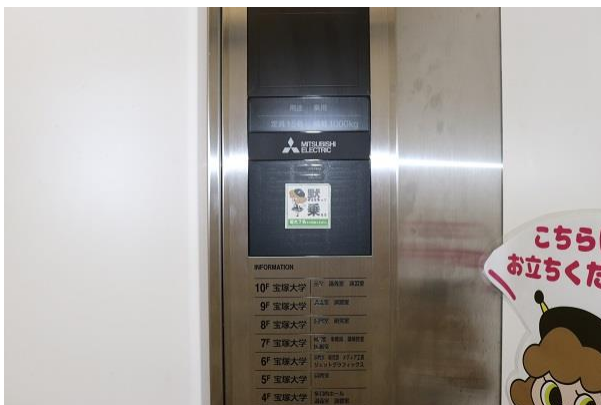
エレベーター内にも「黙って乗ろう」案内を掲示しています (写真：エレベーター内)
